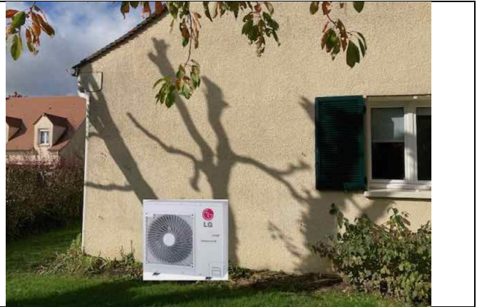
Pignon avec l'unité extérieure
