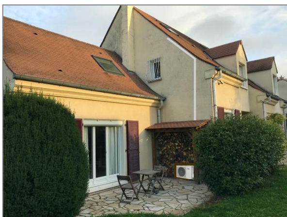
Unité extérieure au sol dans l'abri bois, entourée de végétaux. Goulotte verticale vers les combles - elle sera de la même couleur que le crépi
